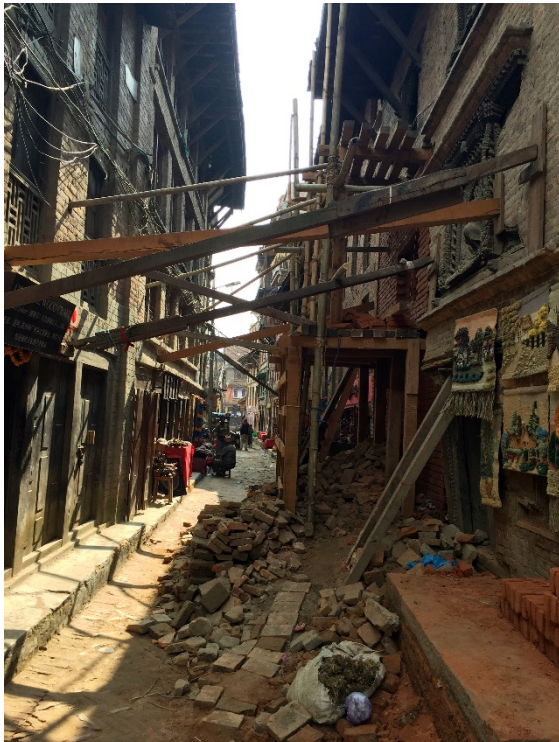
Beschädigte historische Häuserfassade im Touristenviertel von Bhaktapur
