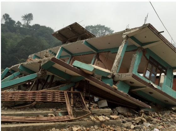
Totalschaden im Distrikt Gorkha, nahe den Himalaya Hauptkamm ca. 10km vom Epizentrum
