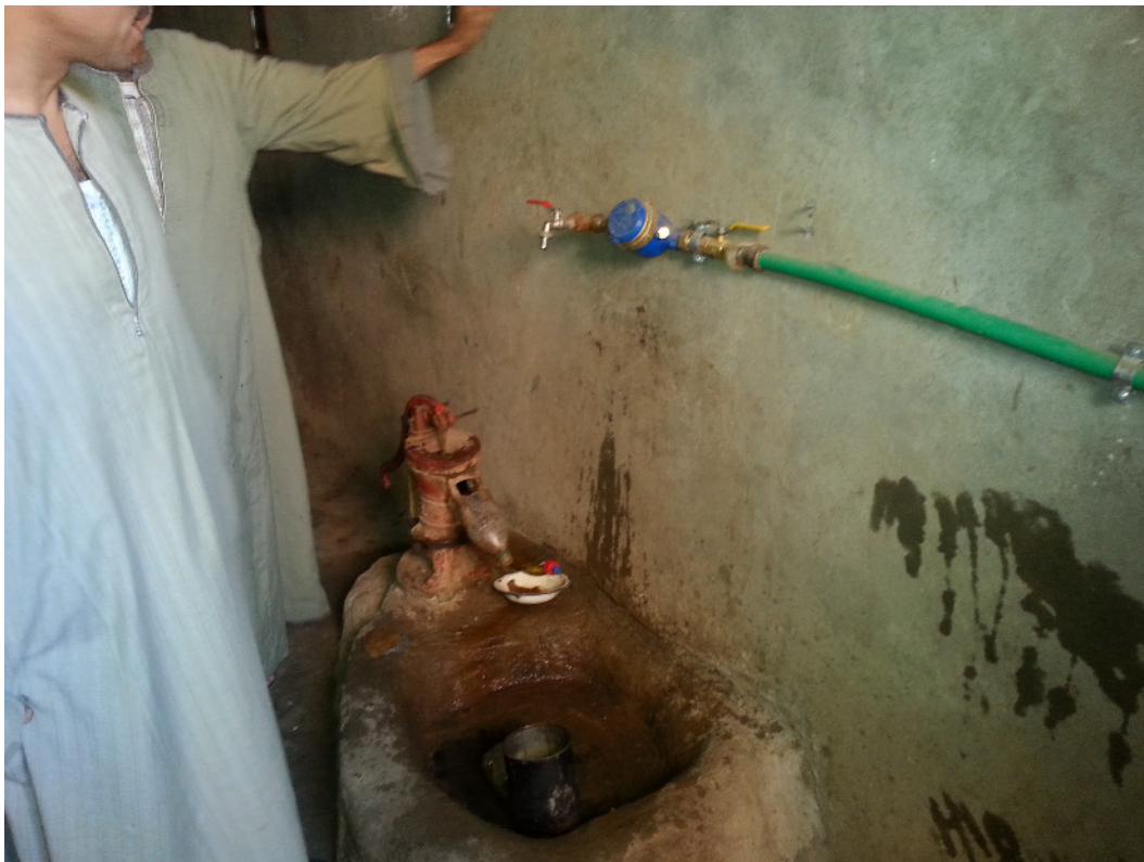
Handpumpe für Grundwasser und neuer Trinkwasseranschluss
